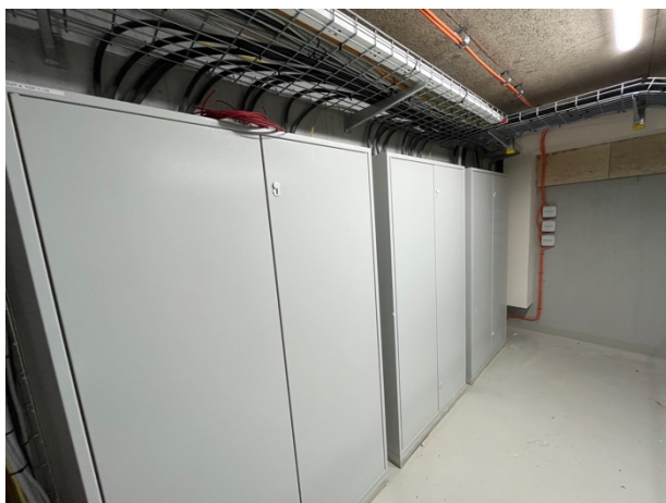
Abbildung 6 - Zählerkästen Wienerstraße (im Technikraum im EG)
