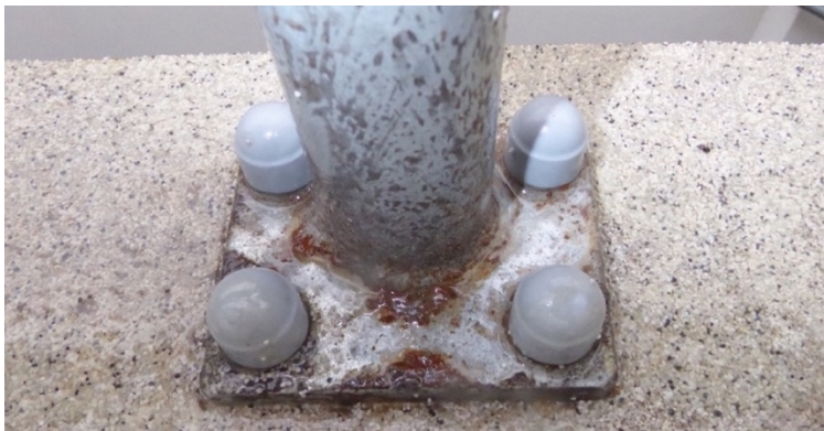
Abbildung 51 - Symbolfoto eines rostigen Geländers
