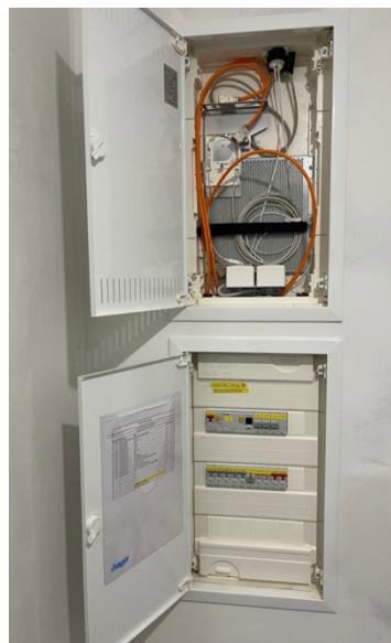
Abbildung 2 - Sicherungskasten Übersicht offen
