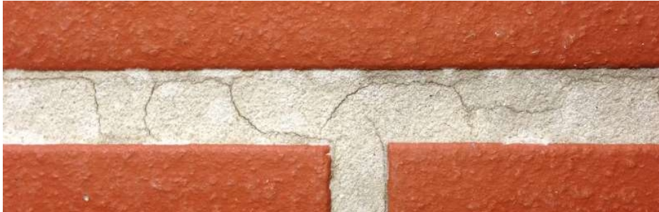
Abbildung 50 - Symbolfoto einer rissigen Fuge im Außenbereich
