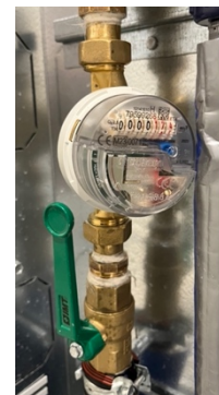
Abbildung 19 – Detail Wasserzähler & Hauptwasserhahn (offen)
