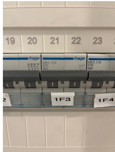
Abbildung 5 - Sicherung "1F3" ist wieder oben
