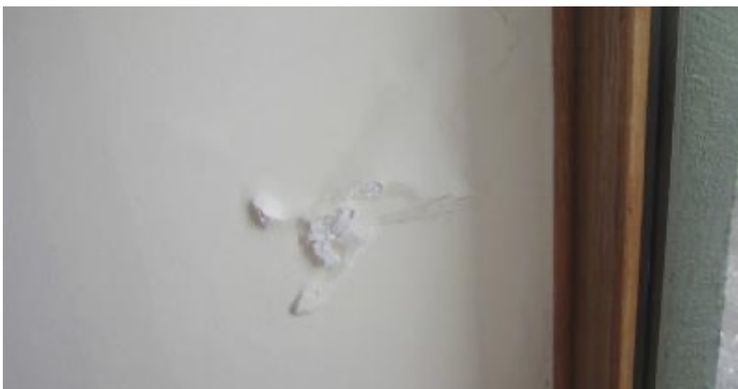
Abbildung 49 - Symbolfoto von Blasenbildung an der Wand aufgrund von Feuchtigkeit
