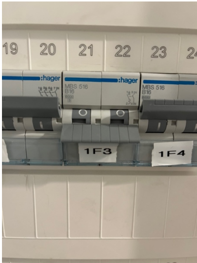
Abbildung 4 - Sicherung "1F3" ist ausgelöst worden
