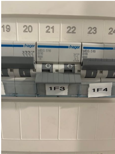
Abbildung 4 - Sicherung "1F3" ist ausgelöst worden
