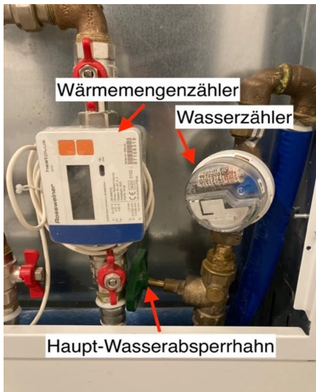
Abbildung 18 - Symbolfoto Wasserabsperrhahn, Wasserzähler, Wärmemengenzähler
