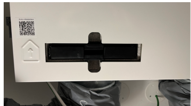
Abbildung 41 - Wohnraumlüftung – Abluft Filteröffnung
