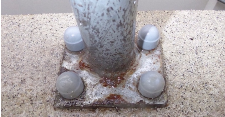
Abbildung 56 - Symbolfoto eines rostigen Geländers
