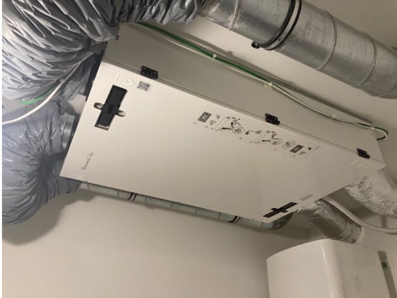
Abbildung 36 - Lüftungsgerät an der Decke des Abstellraums
