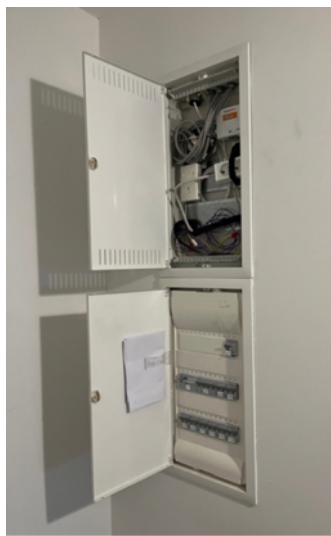
Abbildung 2 - Sicherungskasten Übersicht offen
