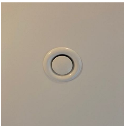
Abbildung 37 - Lüftungsventil für Absaugung
