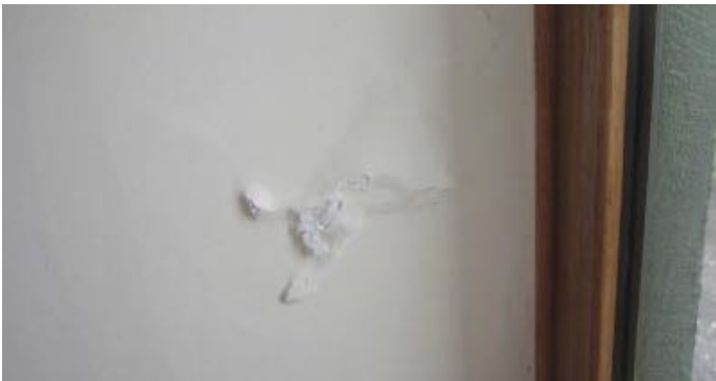
Abbildung 54 - Symbolfoto von Blasenbildung an der Wand aufgrund von Feuchtigkeit
