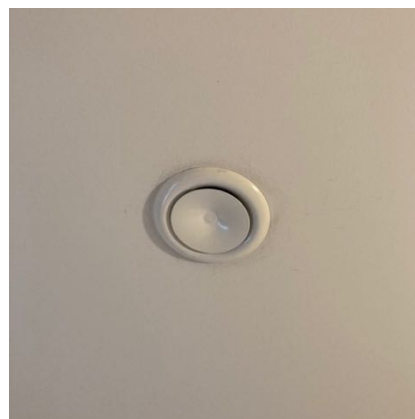
Abbildung 38 - Lüftungsventil für Einblasung
