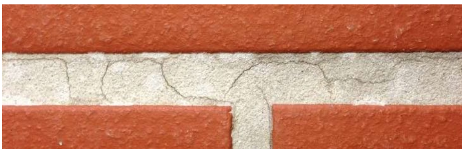
Abbildung 55 - Symbolfoto einer rissigen Fuge im Außenbereich
