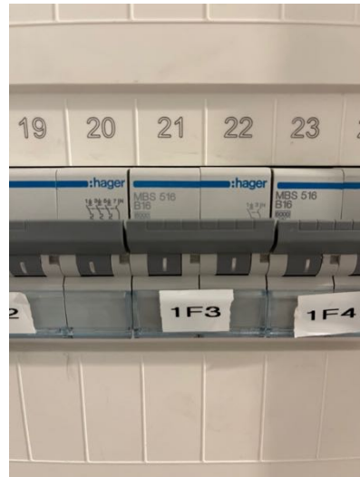
Abbildung 5 - Sicherung "1F3" ist wieder oben
