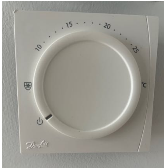
Abbildung 29 - Raumthermostat, Heizung ausgeschaltet
