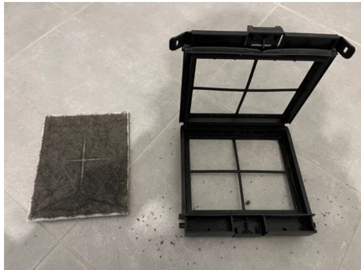
Abbildung 43 - Wohnraumlüftung – verschmutztes Filtervlies wechseln
