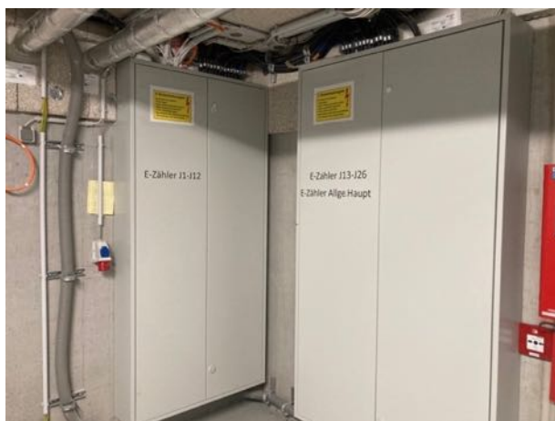
Abbildung 6 - Zählerkästen Josef Wolfik Straße (im Technikraum)
